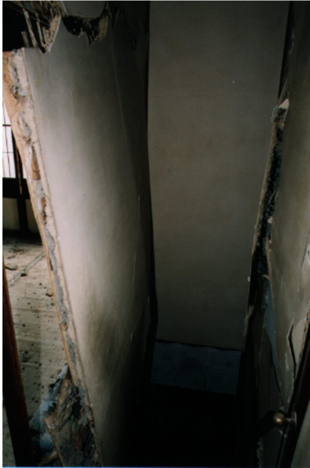
写真 2 SI 邸:2 階の間仕切り壁が外れた
