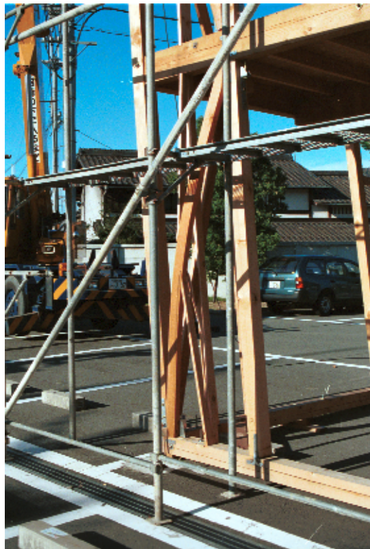
写真 7 H 棟：step105 で間柱が折れた
