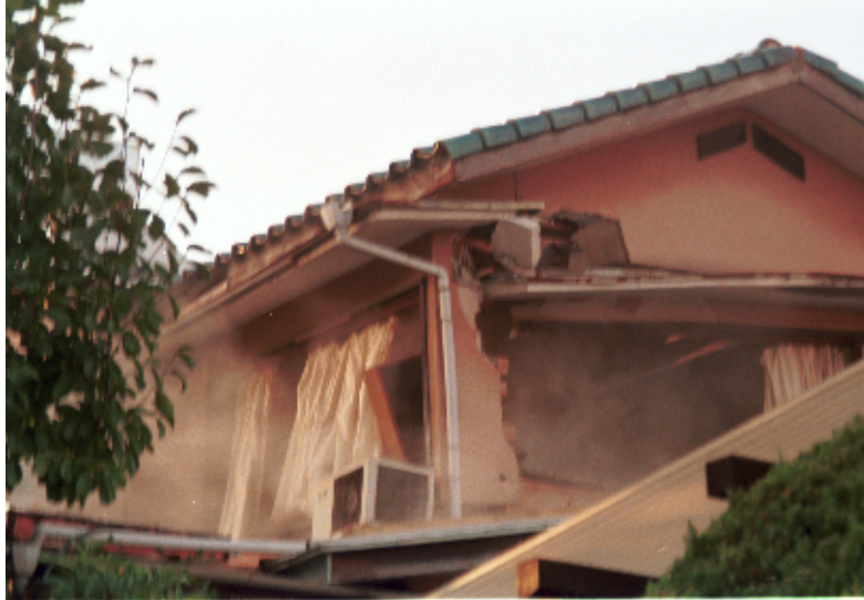
写真 5 TA 邸:2 階南東の隅柱が折れた
