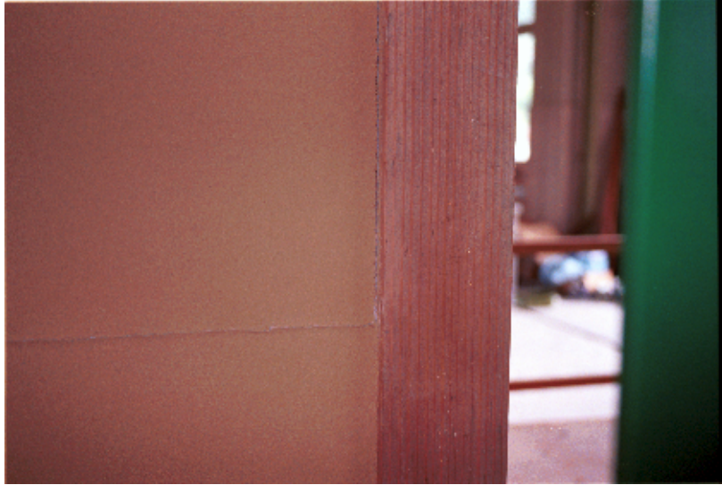
写真 26 試験体 No.1b: ジュラクが水平にひび割れ
