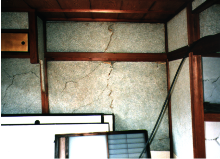
写真 3 SI 邸:2 階の西側土壁のひび割れ
