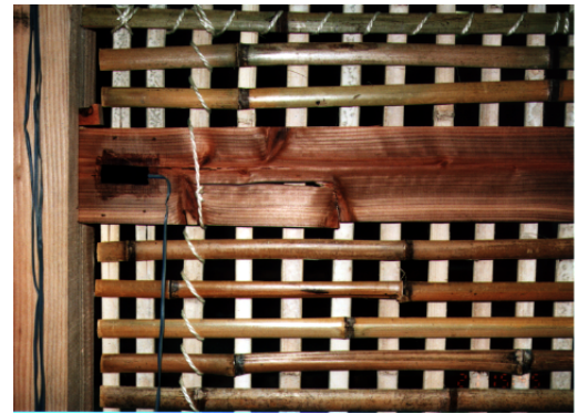
写真 16 試験体 No.2 で、1/10rad 変形時に内法貫が節部分で割れた
