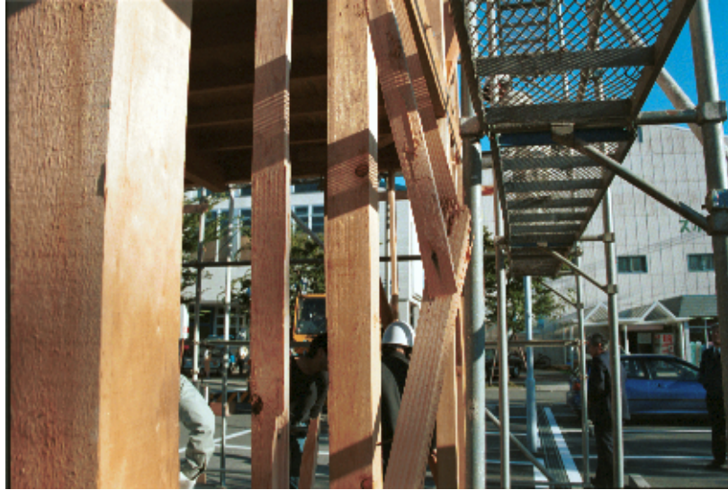
写真 10 H 棟：step119 で 1 階の圧縮筋かいが折れた
