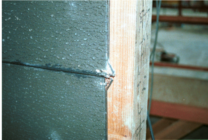
写真 32 試験体 No.4a: ラスカット周辺部の損傷
