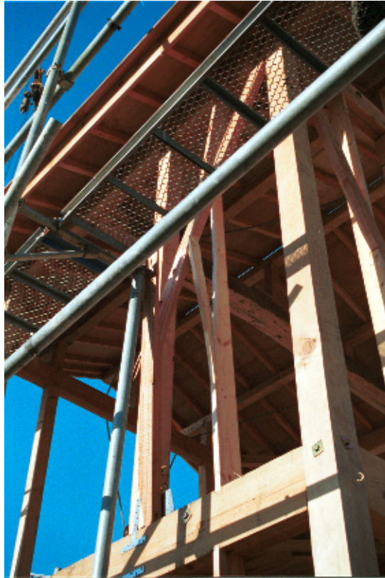
写真 8 H 棟：step111 で 2 階の圧縮筋かいが折れた
