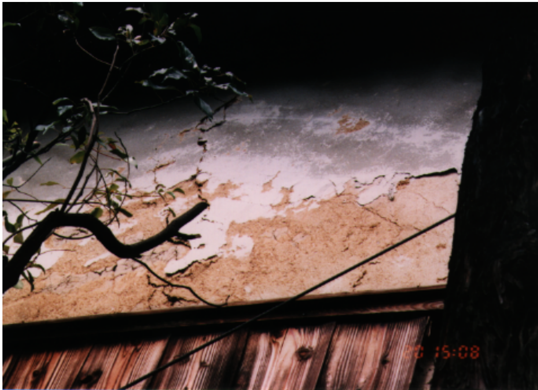
写真 6 SI 邸：外壁が面外に膨らみだした
