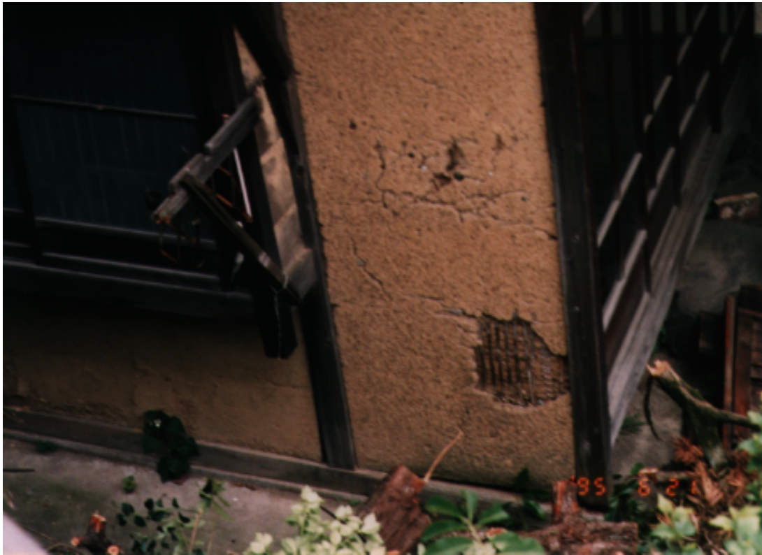
写真 9 TU 邸：壁と軸組の隙間、土台の浮き
