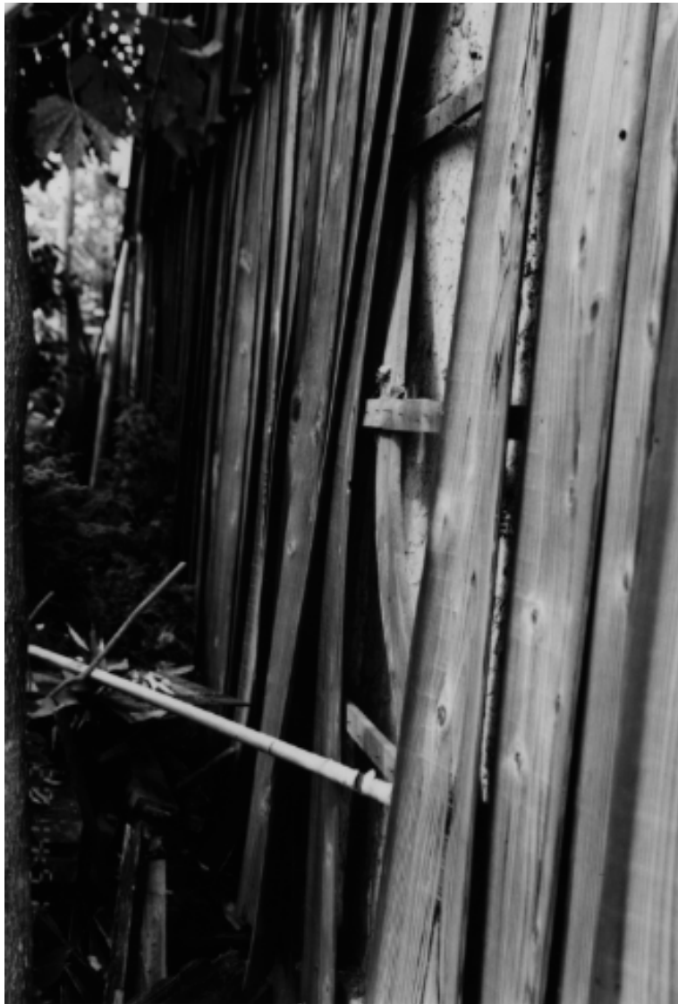
写真 7 SI 邸：斜材の座屈による面外変形
