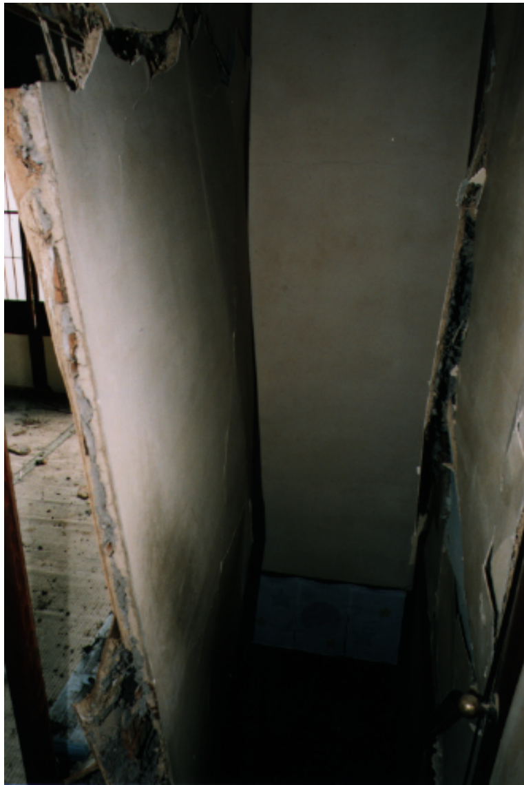
写真 8 SI 邸：土壁の崩壊
