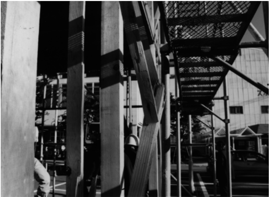
写真 17 H 棟：step119 で 1 階の圧縮筋かいが破断した
