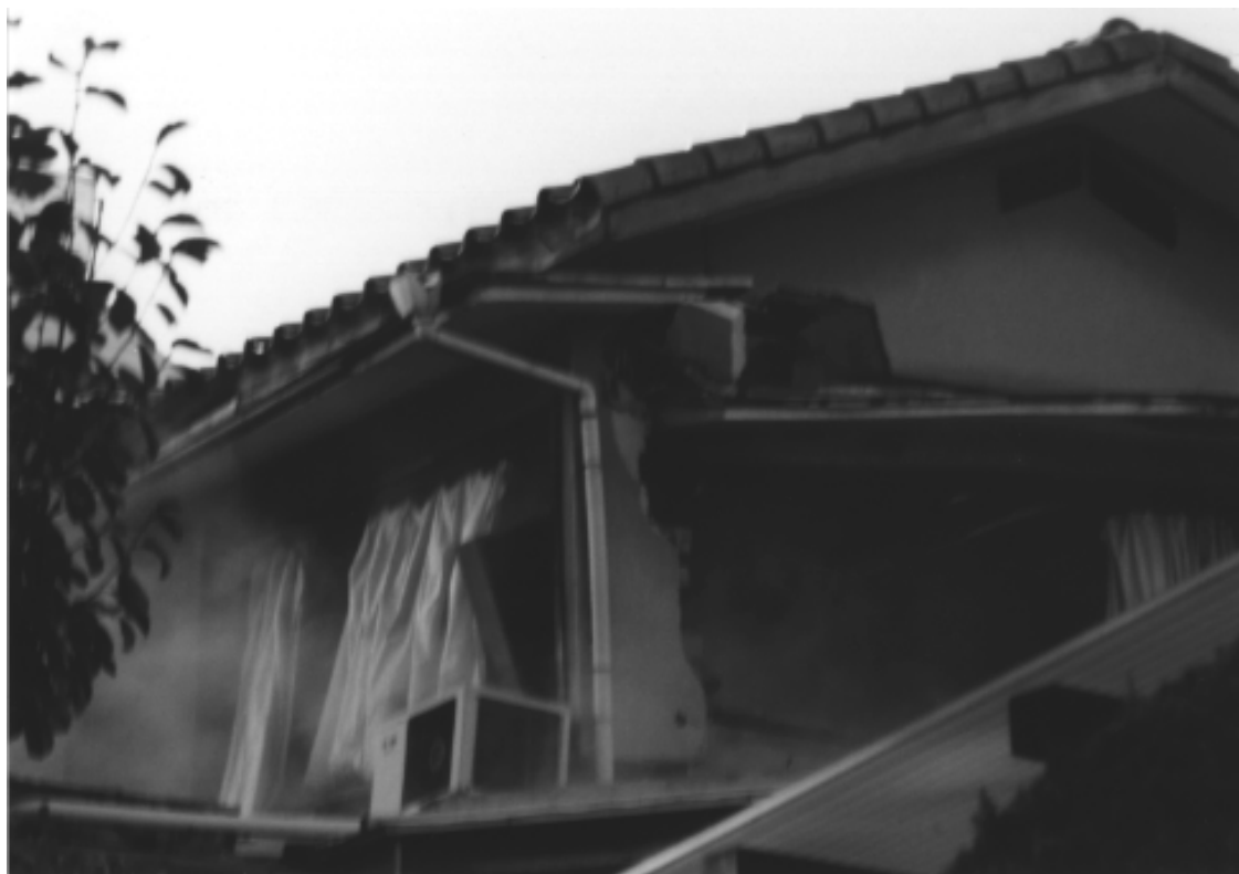
写真 12 TA 邸：柱が外れた
