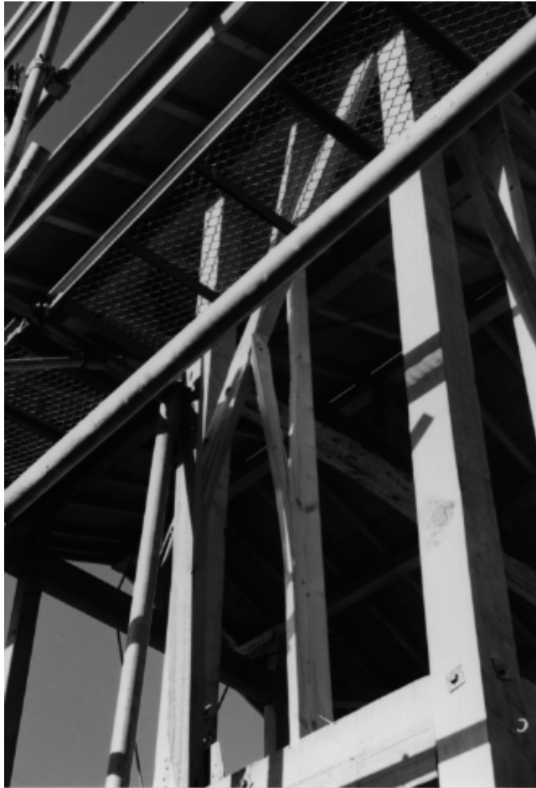
写真 15 H 棟 : step111 で 2 階の圧縮筋かいが破断した
